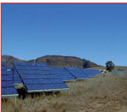
Photovoltaik in Südspanien
