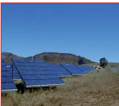
Photovoltaik in Südspanien
