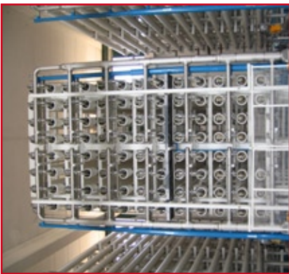
Meerwasserentsalzung in Arabien, Al Fujairah (MSF Anlage) Photos C. Mertes
